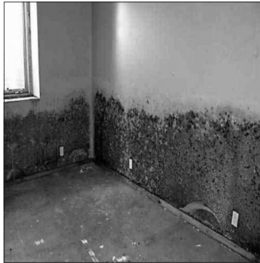
Después de una inundación, el moho y daño extremo a una vivienda presentan peligros considerables de salud para los ocupantes si no se tratan.
